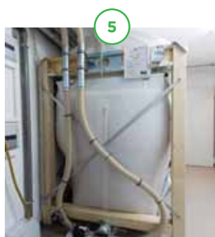
Silo à pellets
